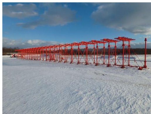
進入方向(横位置)を示すためのローライザアンテナ
